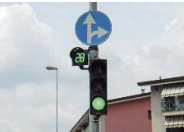
Un esempio di contasecondi installato su un impianto semaforico
